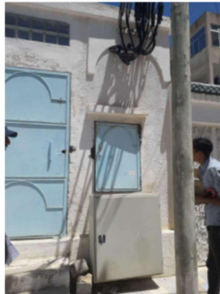
Poste avec variateur fonctionnel
